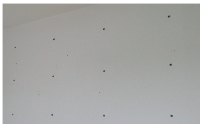
Borehuller i væggen.
