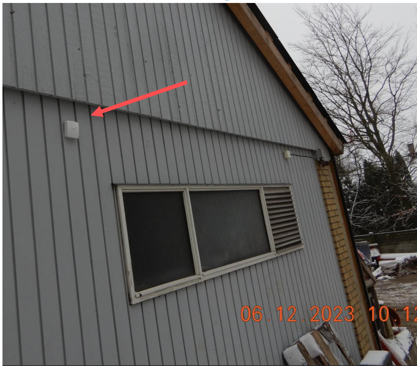
Udeføler monteret på syd-facade
