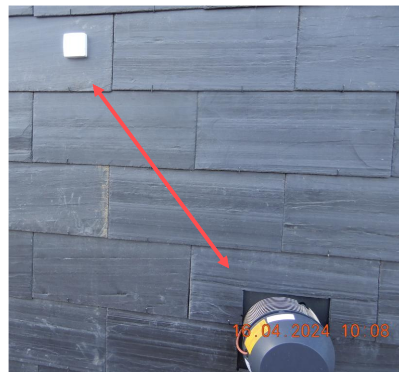
Udeføler er nu flyttet 1,8 m over jord - Men 0,95 m fra afkast ventilator føler påvirkes stadig
