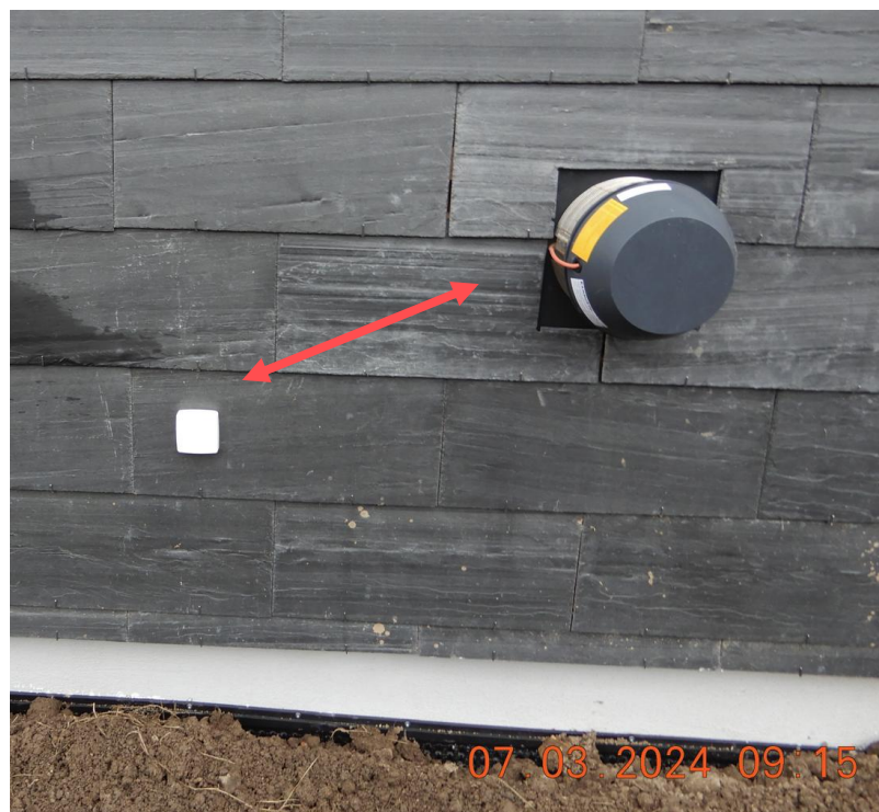
Udeføler flyttes til nordfacade, men 0,6 m over jord og 0,7 m fra afkast ventilator – Føler påvirkes
